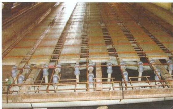
Detailopname CiC systeem bed koeling en verwarming.
